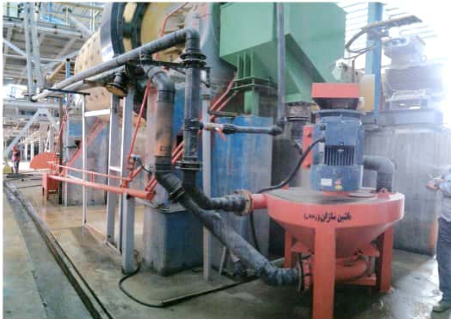
پمپ ورتیکال مخروطی شکل طرح شرکت میتسو در حال کار
